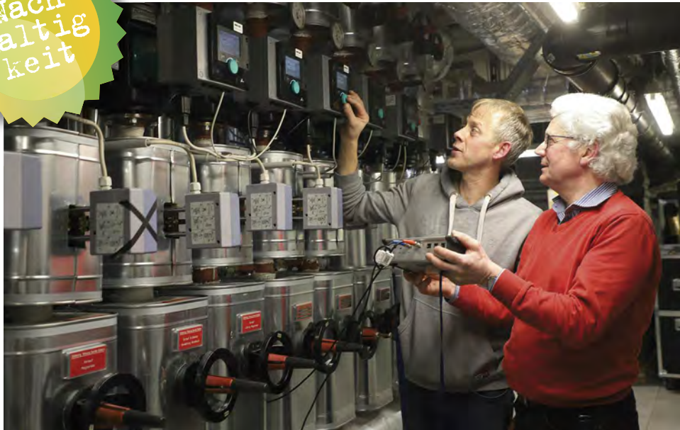
Im Bauch der Technikzentralen haben Michael Mangels und Josef Strohbücker (r.) von der stiftseigenen Betriebstechnik ihren Wirkungsbereich. Mit teurer Messtechnik ermitteln sie Potenziale, um die Anlagen für Heizung und Warmwasser zu optimieren.
